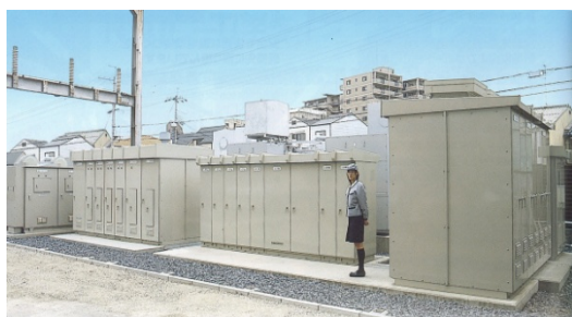
日新電機本社構内 22kV 受電所(写真提供:日新電機)
